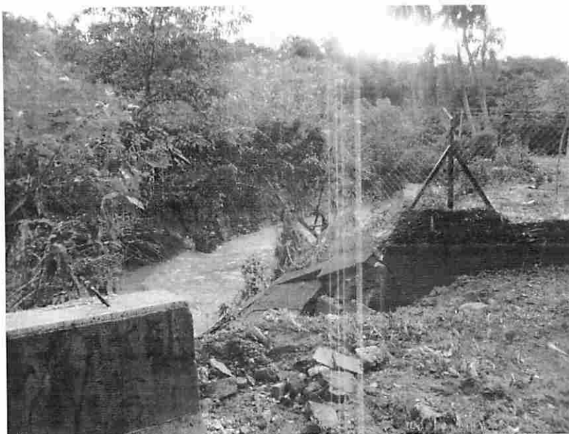
Foto 42. Parte danificada da ponte.
