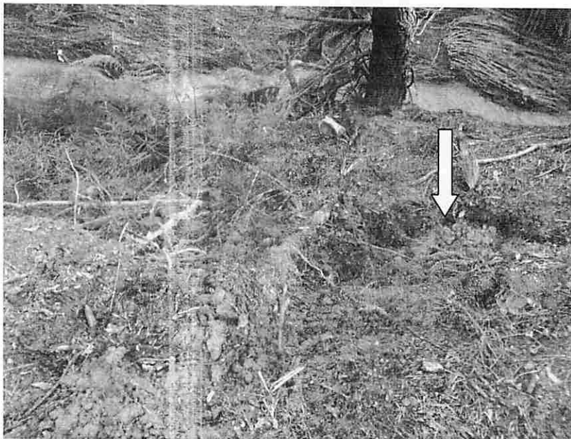
Foto 57. Formação da erosão próximo ao córrego.
