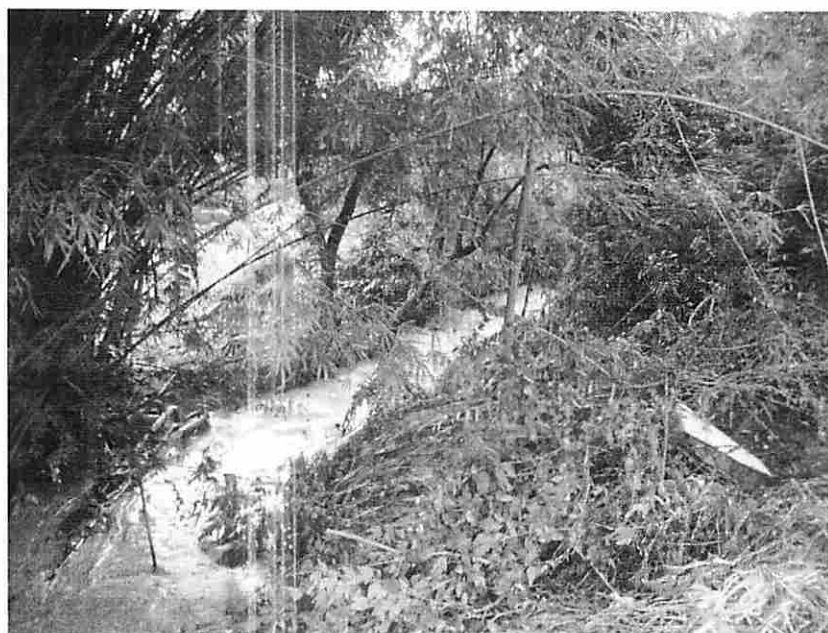
Foto 37. Leito do córrego que vai par a aduela, necessita de limpeza ao redor para não entupir.
