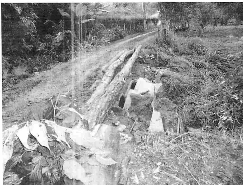
Foto 46. Tubulação da ponto exposto, parte da ponte cedeu dando risco dos moradores daquela região, pois é o único caminho para a saída das casa deles.
