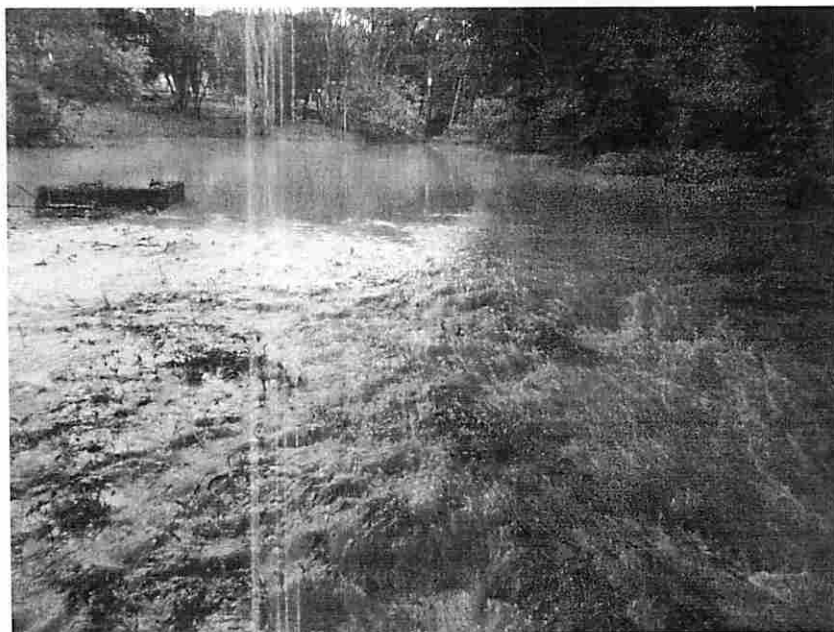
Foto 22. Local próximo do lago 2 onde a água está passando por cima do talude, houve erosão e com a força da água a vegetação foi retirada.
