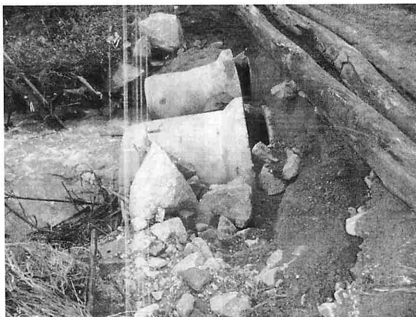
Foto 47. Parte da ponte onde cedeu que necessita de manutenção.
