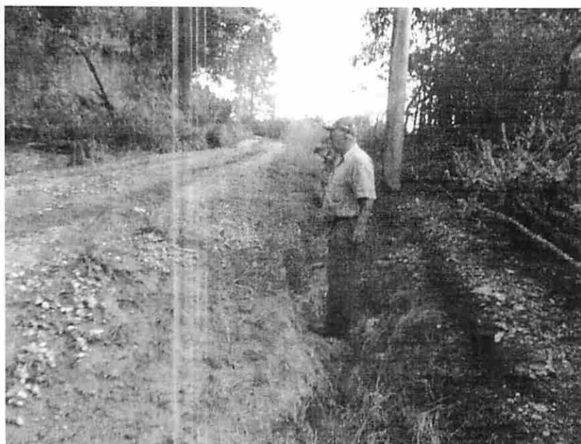
Foto 64. Tamanho da erosão formada ao lado da estrada, onde passa o escoamento da água pluvial, em outros pontos possui erosão menores porem os moradores não conseguem usar essa via.
