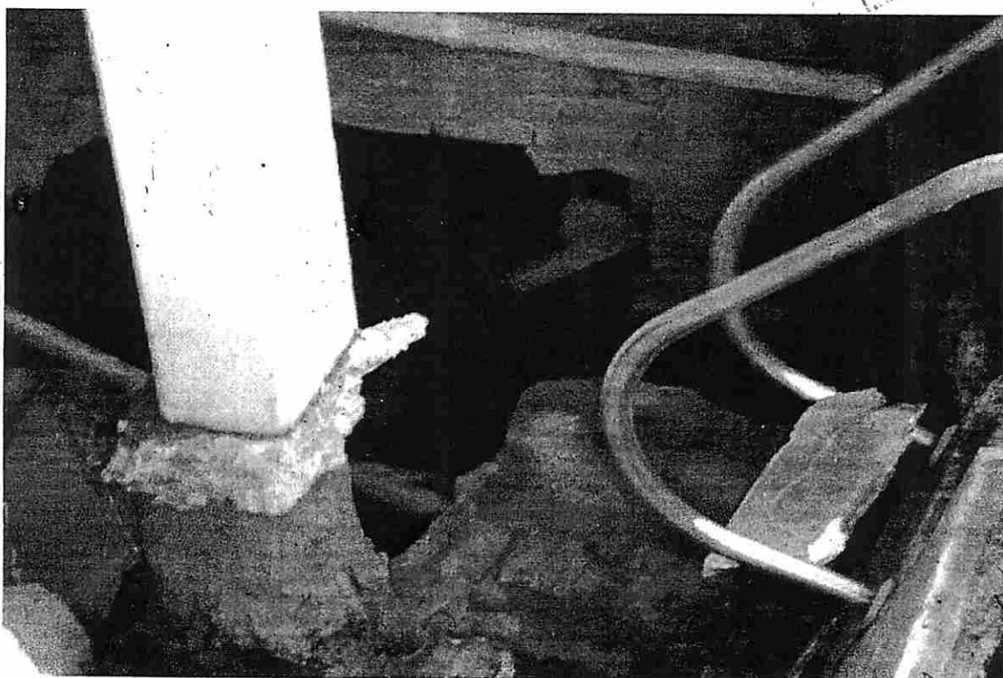
Foto 04) Galeria onde houve o rompimento.
