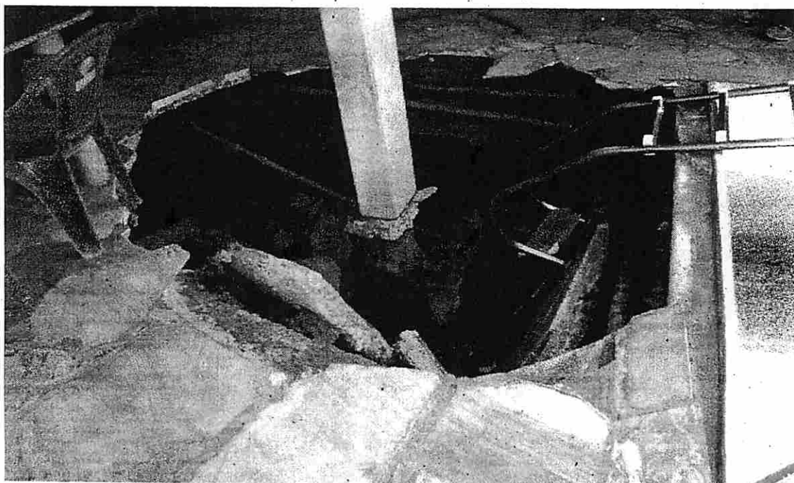
Foto 03) Galeria de águas pluviais rompida e canalização de esgoto ao lado da piscina.
