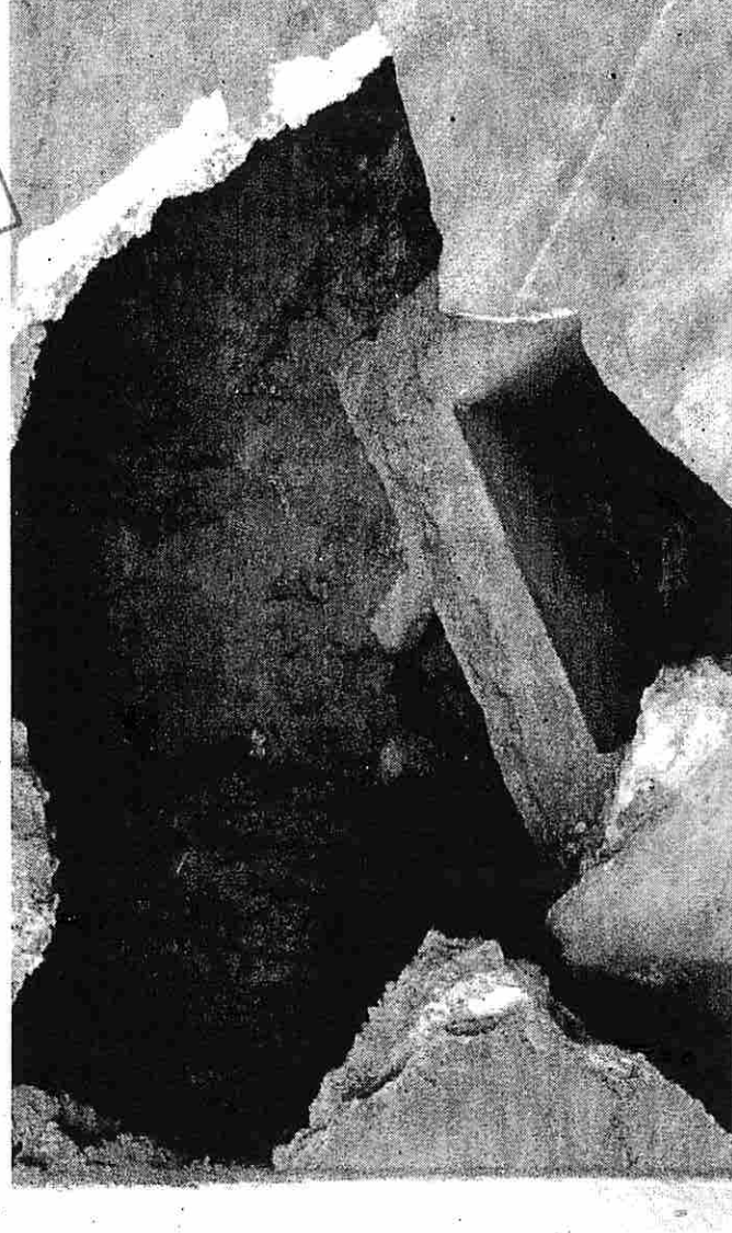
Foto 05) Galeria apresenta fuga de material.
