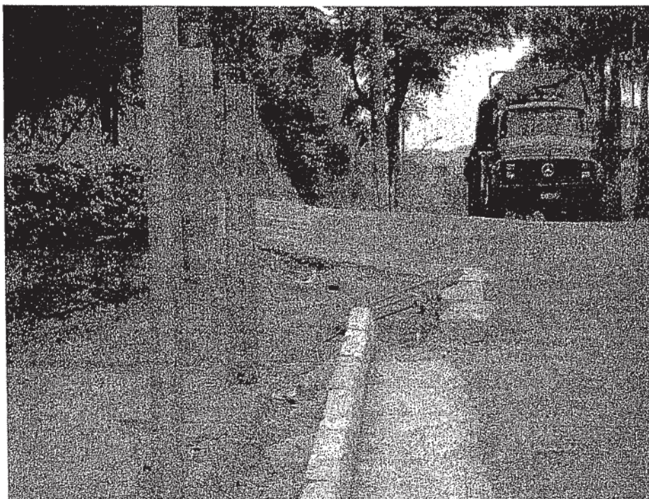
Guias soltas causando risco de acidente
