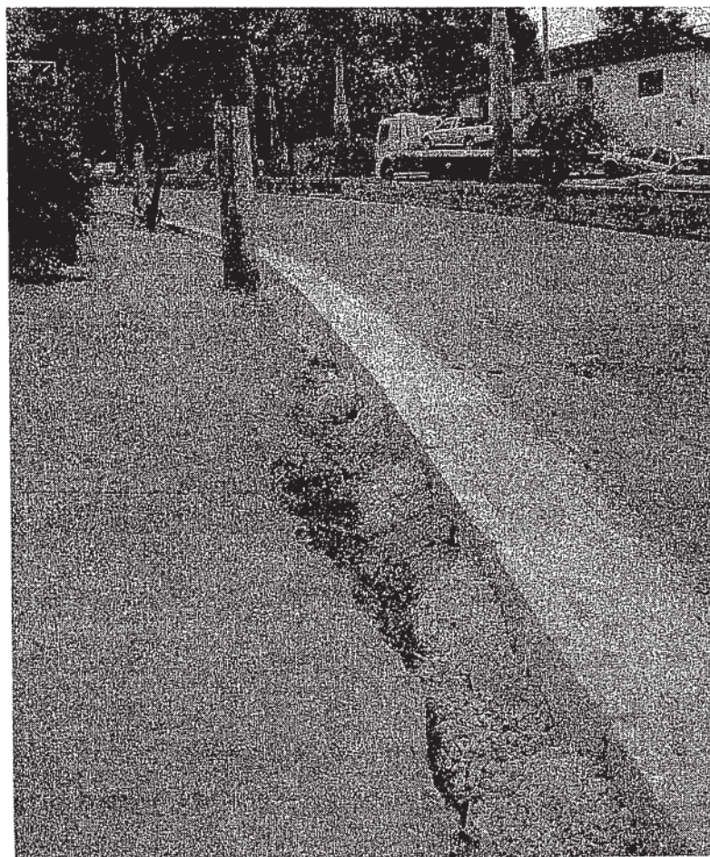
Buracos não aterrados causando perigo aos pedestres
