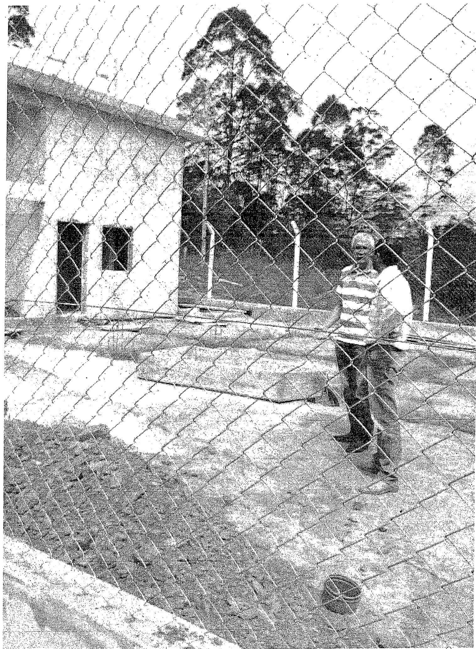
Estação de Tratamento - bairro do Carmo.
