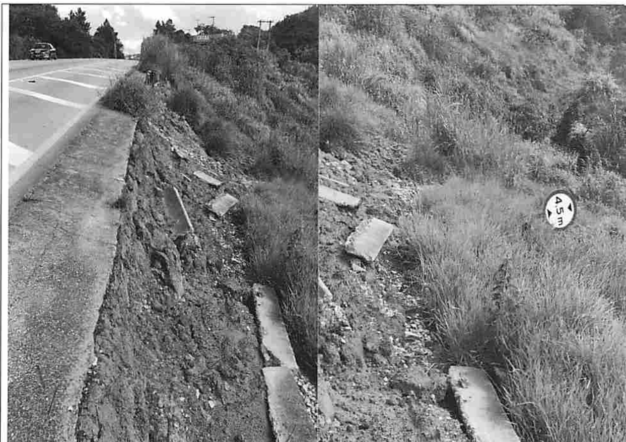
Foto n.º 24 – Km 08 – erosão do talude e rompimento da canaleta de concreto
