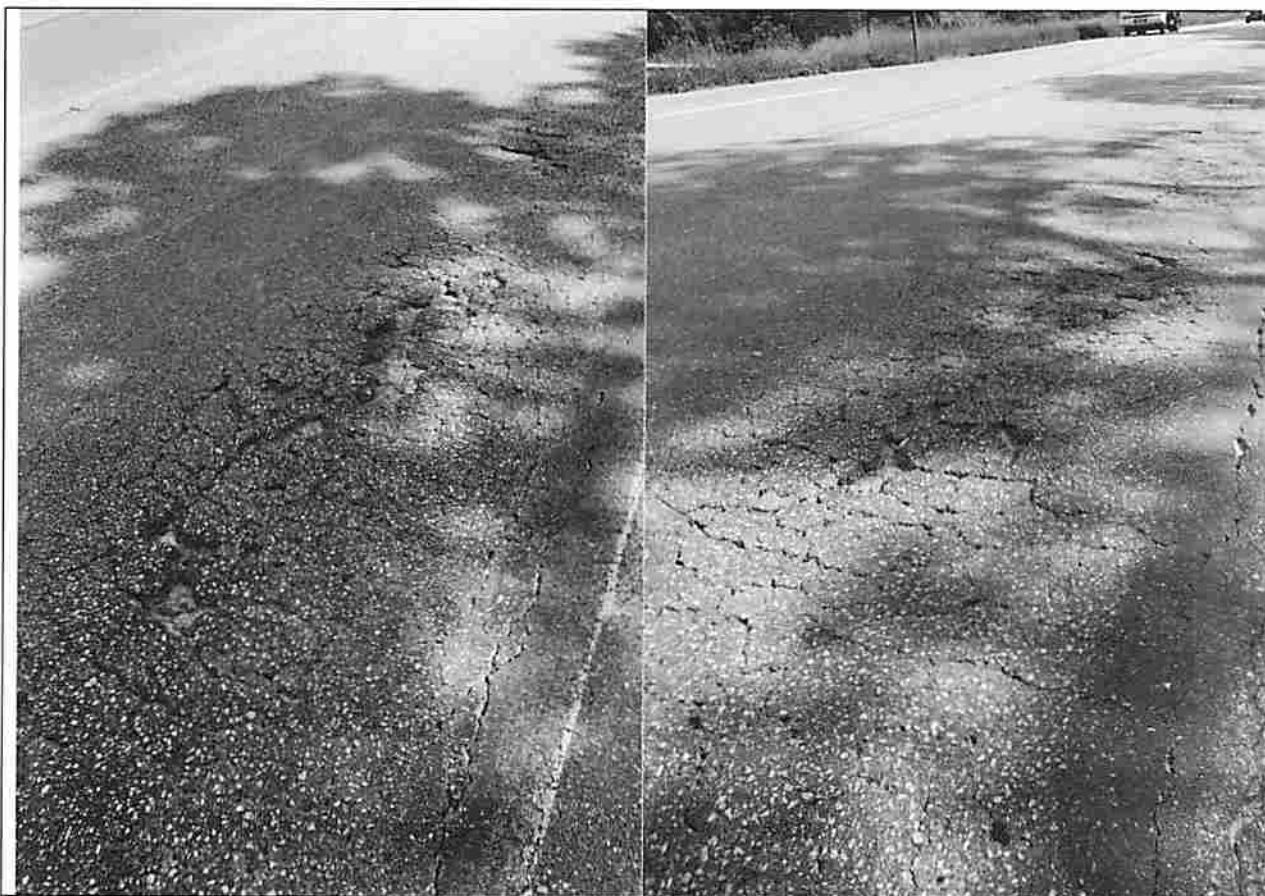
Foto n.º 01 – Km 02 – Trincas, fissuras e buracos na pista de rolamento da Rodovia
