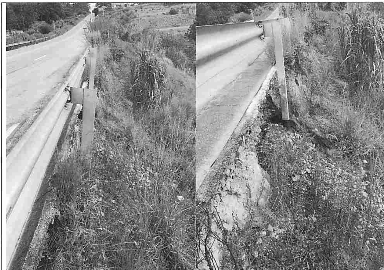
Foto n.º 20 – Km 7,5 – agravamento da erosão do talude
