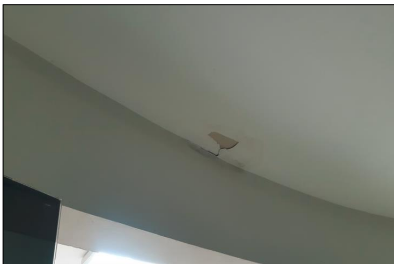
Imagem 3- Forro do Plenário lado externo com sinais de dano por infiltração
