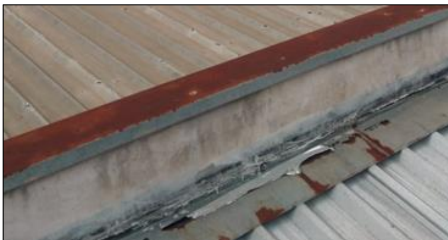
Imagem 11 – Rufos em condições inadequadas de utilização
