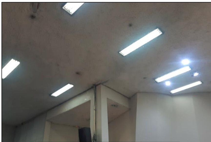
Imagem 1- Forro do Plenário com sinais de gotejamento pontual
