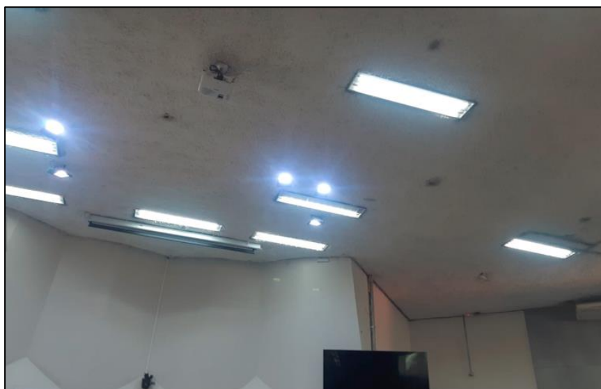
Imagem 2- Forro do Plenário com sinais de gotejamento pontual
