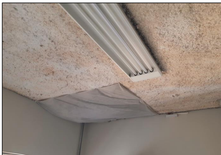
Imagem 5- Forro do “plenarinho” danificado devido ao acúmulo de água
