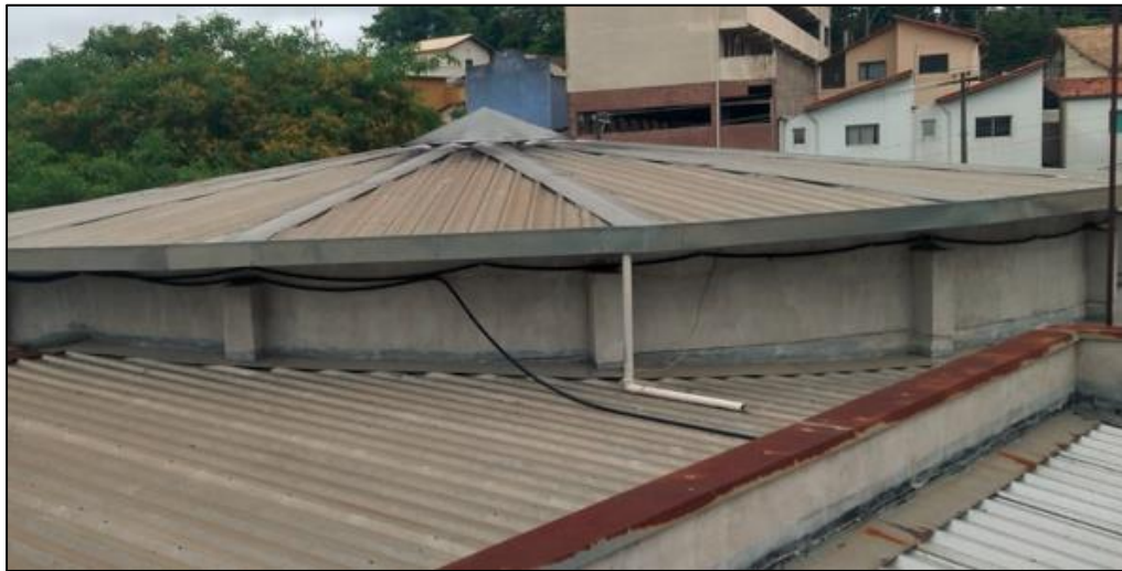
Imagem 15 – Coletor da calha inadequado com desague de água pontual sobre telhado
