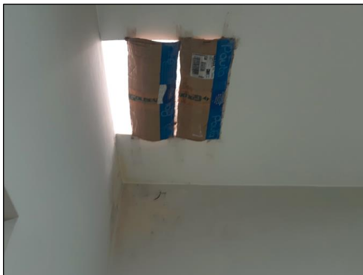
Imagem 7 – Teto e paredes da sala do Gabinete 1 com sinais de umidade e infiltração
