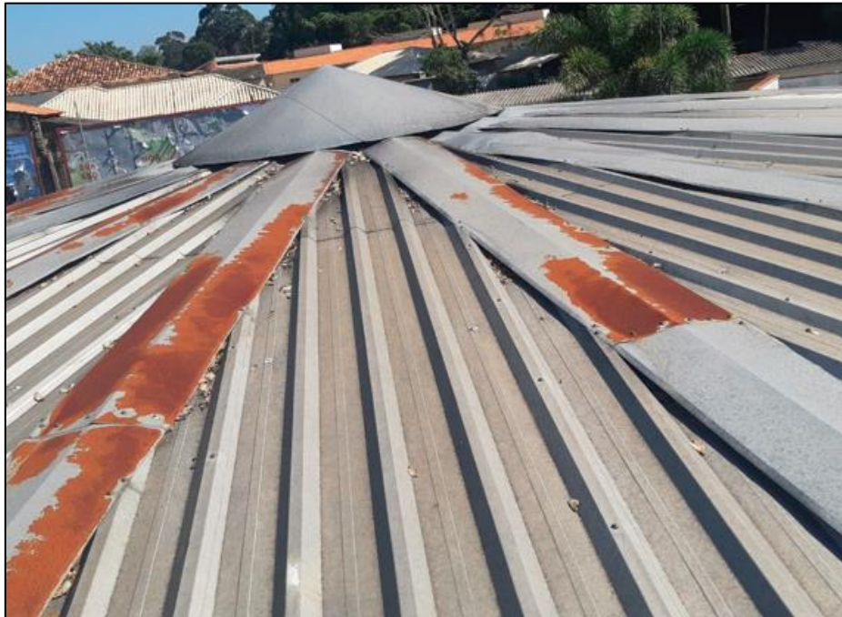
Imagem 13 – Cumeeiras em condições inadequadas para utilização
