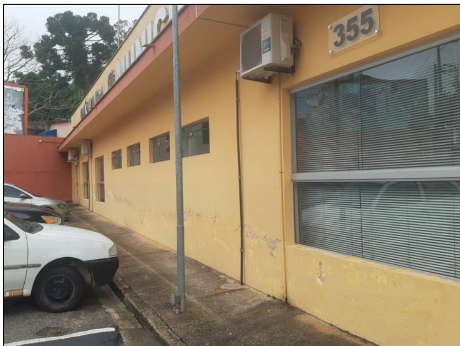
Imagem 9 – Fachada de frete ao estacionamento externo com pintura danificada devido à umidade existente.
