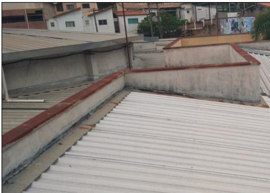
Imagem 12 – Pingadeiras em condições inadequadas de utilização
