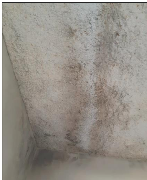
Imagem 6- Forro do “plenarinho” com sinais de umidade
