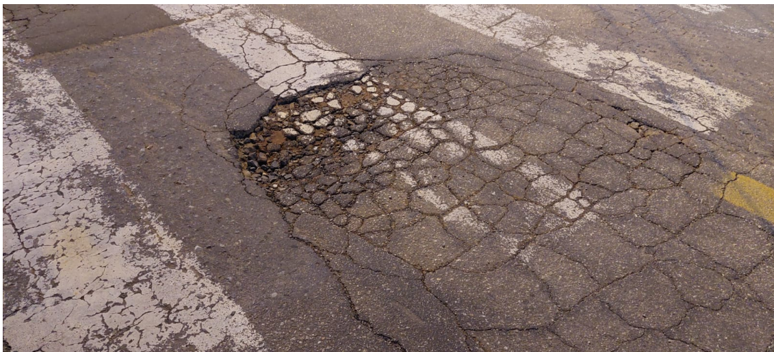
Figura 1 - Av. 3 de Maio, nº 988, defronte a faixa de pedestre do Mercado CZ e a Casa de Ração Bonanza.
