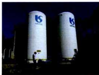
Foto 156- Reservatórios Pavão 1 e 2
