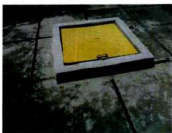
Foto 213- Reservatório-ETA São Roque
