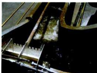
Foto 210- ETA São Roque
