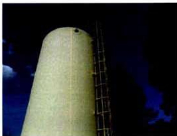
Foto 187- Reservatório do Carmo
