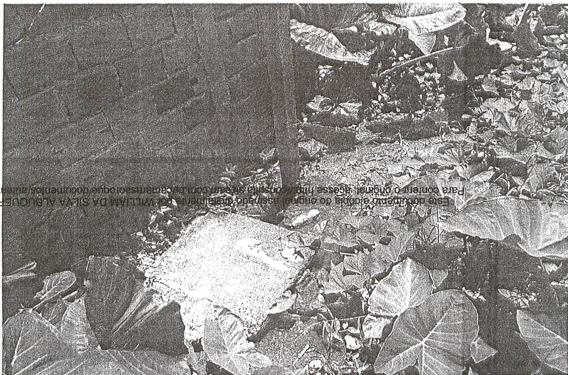
Vazamento do Esgoto na área situada atrás da Rua Paolo Sabatine
