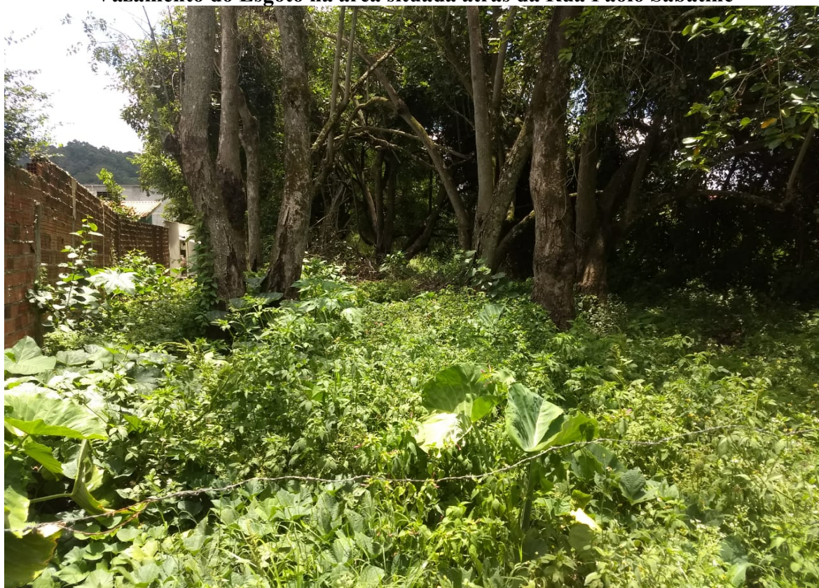
Mato cobrindo vazamento do esgoto (09.02.2021)
