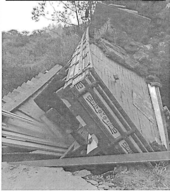
Ponte ficou destruída após acidente
