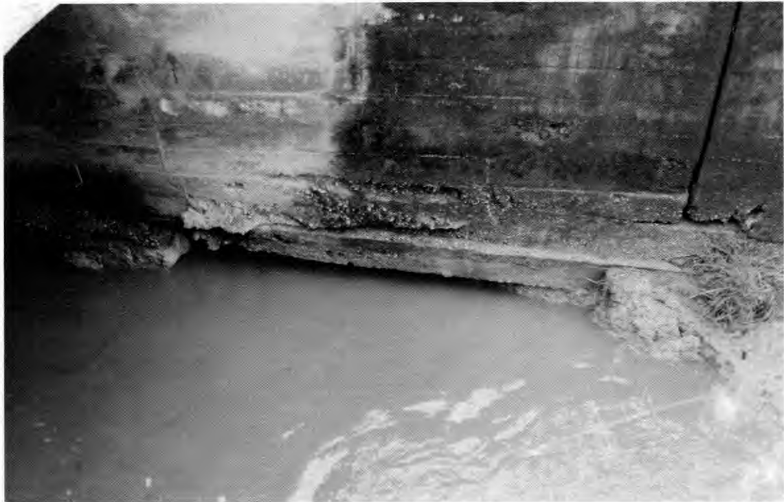
Infiltração embaixo do paredão.
