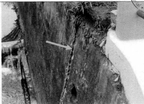
FOTO 3 – Detalhe da movimentação da parede de concreto (seta amarela).
