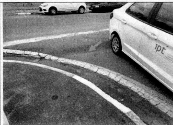
FOTO 7 – A seta amarela indica o ponto onde está ocorrendo rebaixamento do pavimento flexível (cerca de 15 cm) em função do solapamento das paredes do canal de drenagem.
