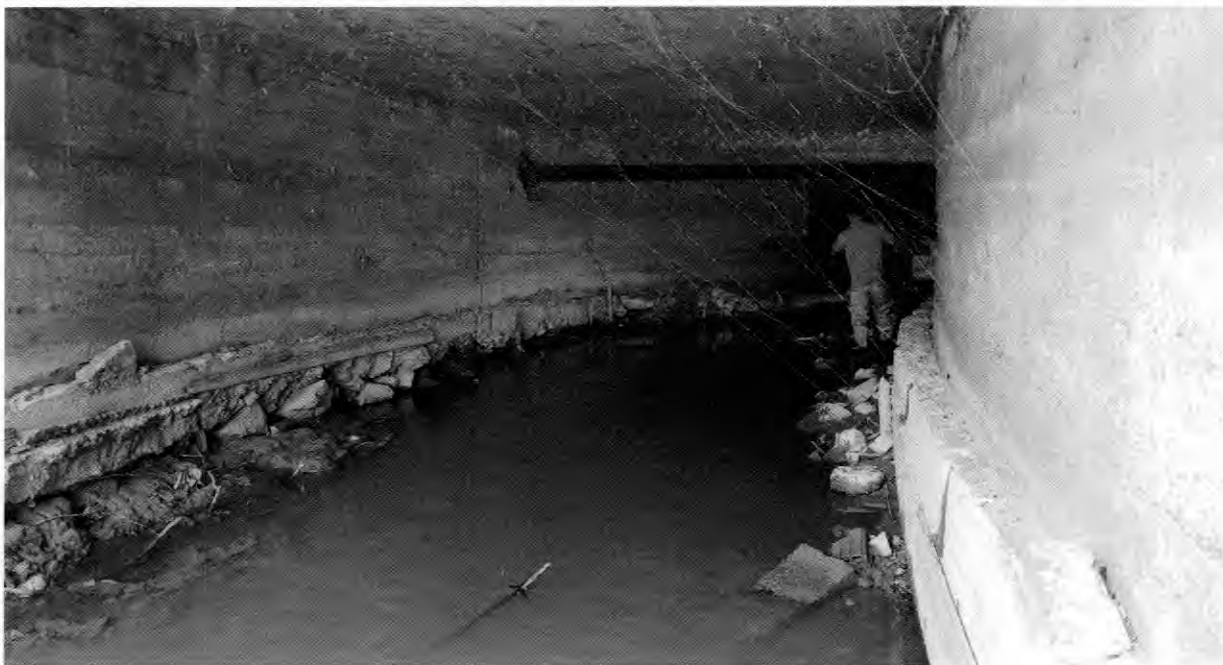
Foto 06 - Verifica-se a necessidade de execução do fundo do rio para conter o solapamento. Em detalhes verifica-se a curva do Ribeirão Aracaí.
