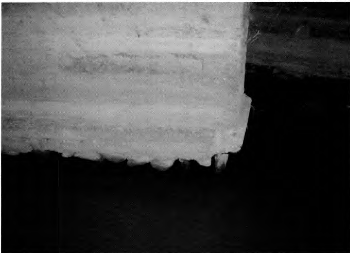
Foto 05 - Verifica-se a necessidade de execução do fundo do rio para conter o solapamento. Em detalhes verifica-se a exposição das estacas de madeira na confluência do Ribeirão Aracaí e Ribeirão Carambé.
