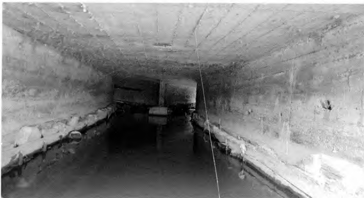
Foto 07 – Vista interna da confluência entre o Ribeirão Carambeí e Ribeirão Aracaí. Verifica-se a grande profundidade no leito demonstrando a necessidade da execução do serviço.
