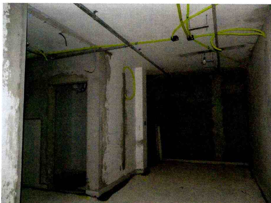
Infraestrutura de gases medicinais, ar-condicionado e elétrica
