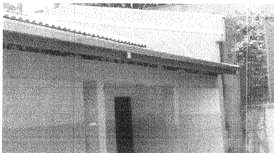
CANALETAS SEM CALHAS/INFILTRAÇÃO
