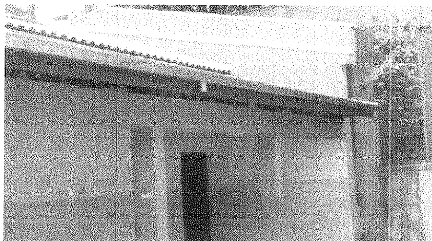
CANALETAS SEM CALHAS/INFILTRAÇÃO
