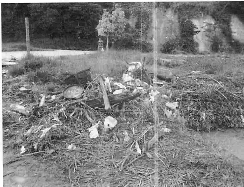
Foto 31. Vistoria na ponte, nota-se vários resíduos no local, possível problema de entupimento dos tubos.
