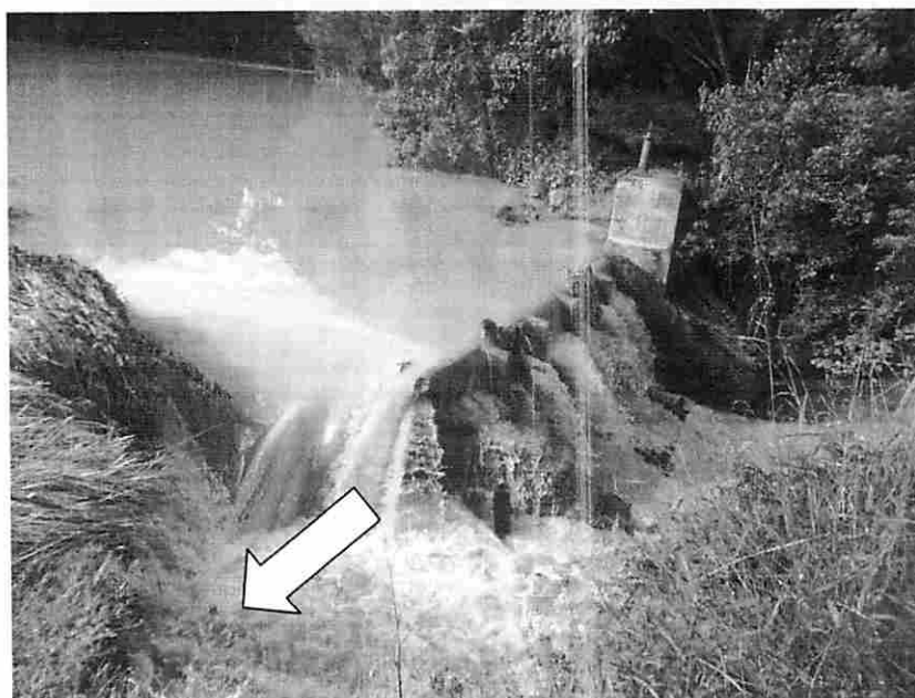
Foto 28. Parte rompida formando erosão próximo, sugerimos manutenção no local.
