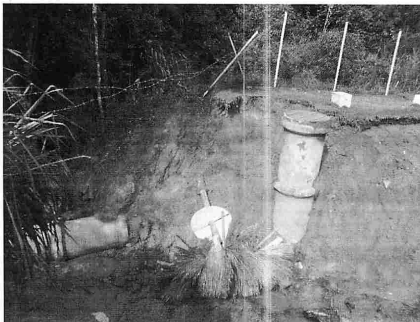
Foto 06. Local do rompimento, nota-se que o sumidouro era mal dimensionado para a quantidade de água no tanque.
