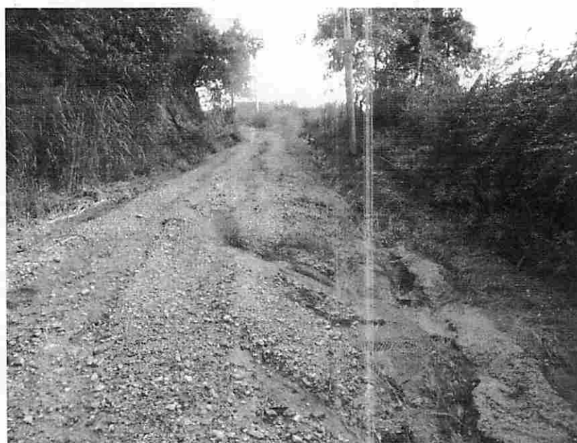
Foto 63. Estrada que segue ao lado da chácara vistoriada, com muita erosão, moradores da continuidade dessa via não conseguem passar de carro baixo.
