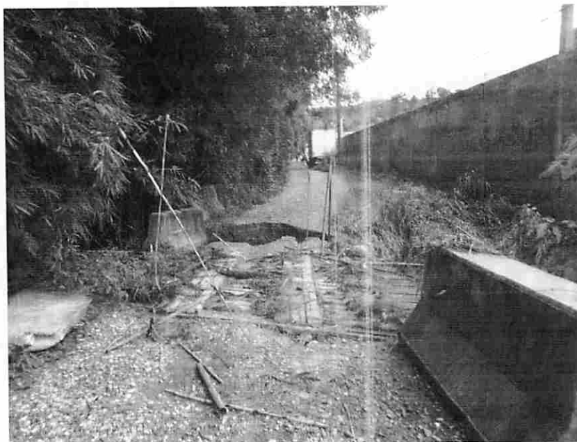
Foto 41. Ponte danificada pela ação da água.
