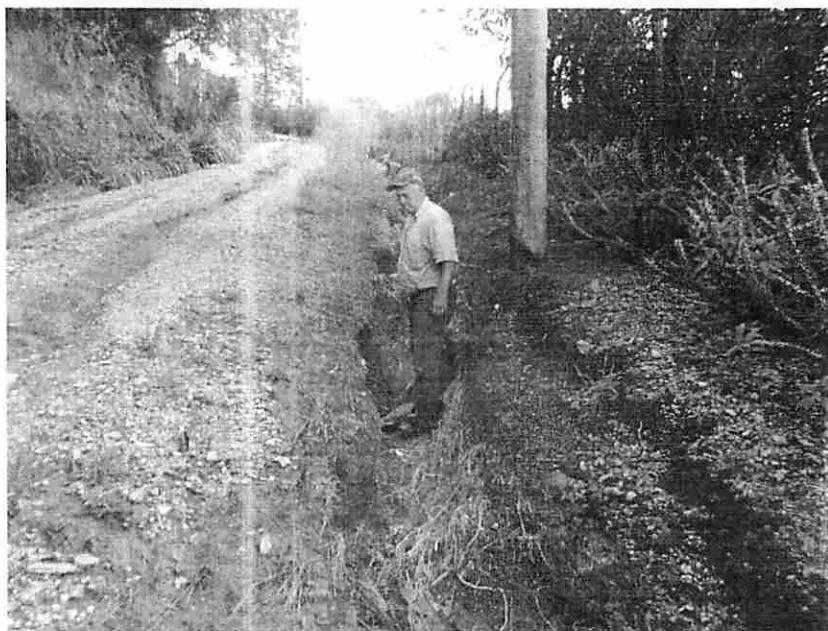
Foto 65. Tamanho da erosão formada ao lado da estrada, onde passa o escoamento da água pluvial, em outros pontos possui erosão menores porem os moradores não conseguem usar essa via.
