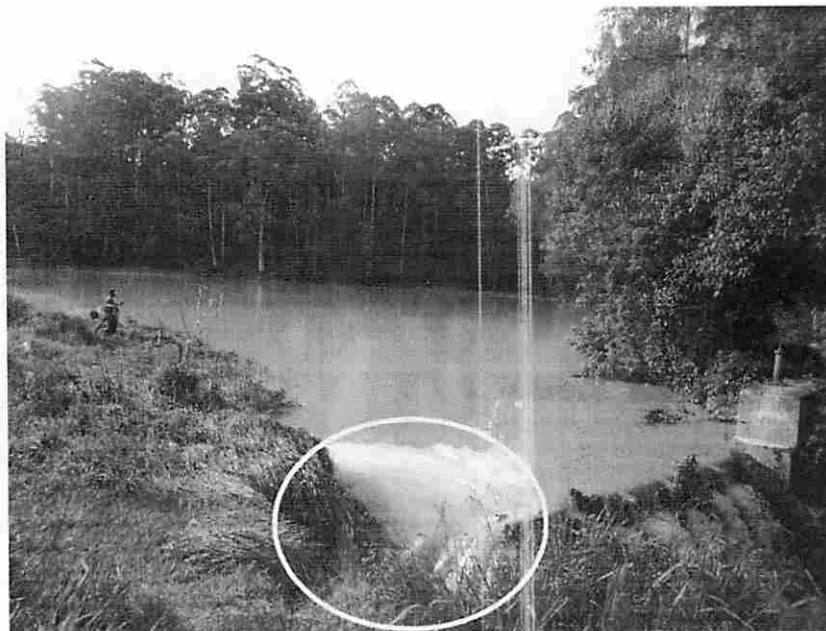
Foto 27. Barragem próximo a escola projeto no goiana, no momento da vistoria a água estava passando por cima da barragem, em amarelo nota-se que houve um rompimento, sugerimos uma manutenção no local.
