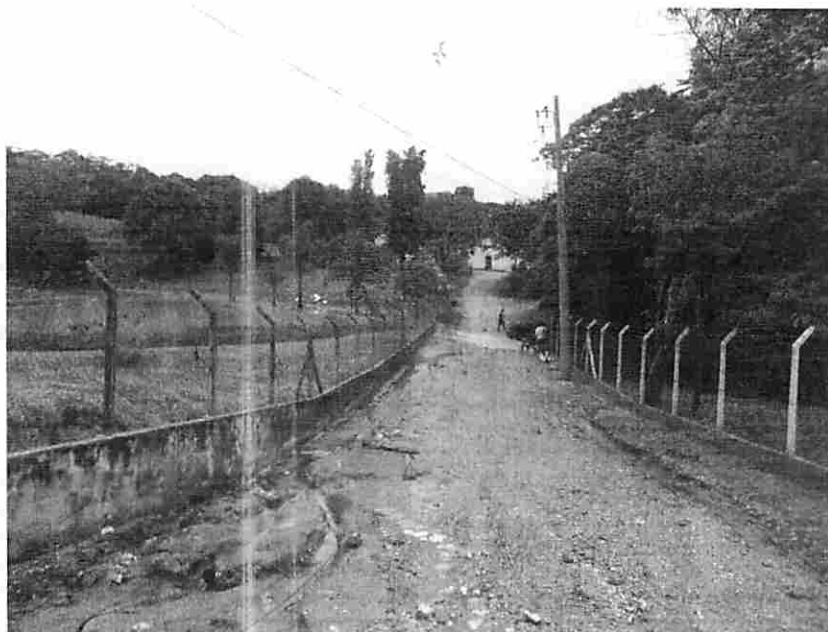
Foto 17. Local onde a água passou para via, houve erosão perto do tubo do sumidouro e o mesmo não foi o suficiente para o lago, provavelmente os tubos estavam entupidos.
