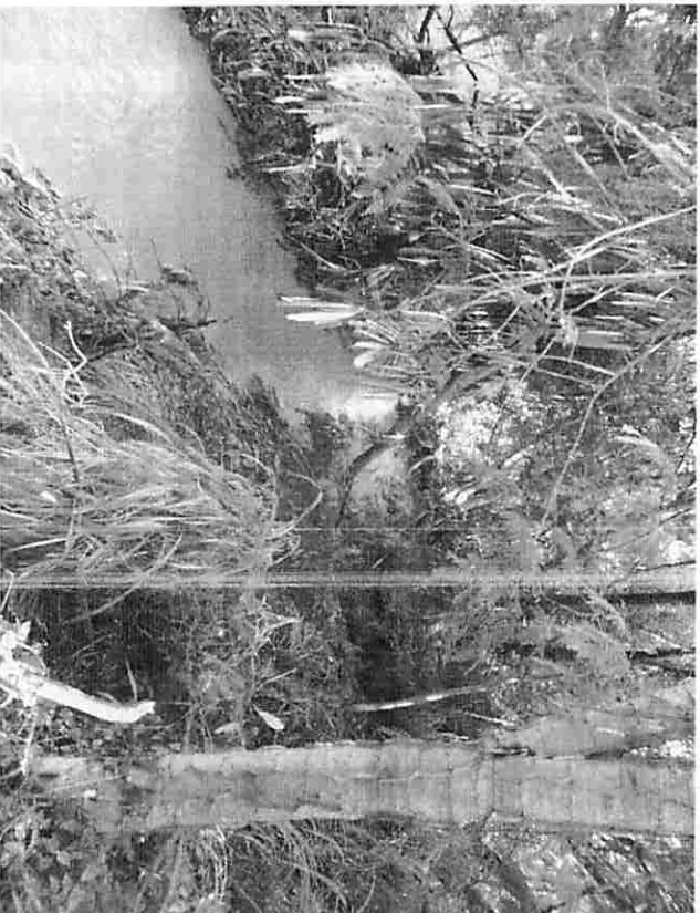
Foto 38. Leito do córrego que vai par a aduela, necessita de limpeza ao redor para não entupir.
