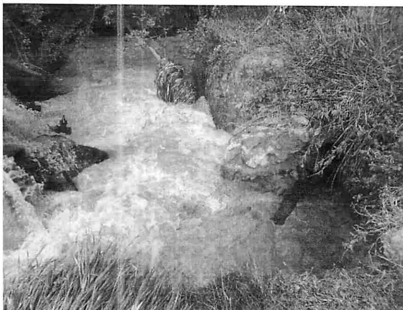
Foto 29. Erosão formado pela força da água, próximo a barragem.
