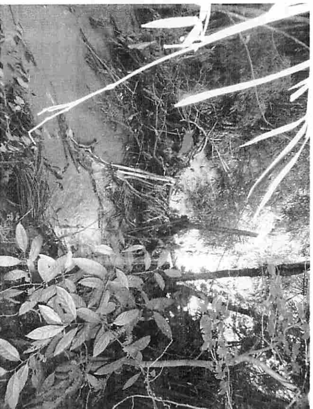
Foto 39. Leito do córrego que vai par a aduela, necessita de limpeza ao redor para não entupir, nota-se vegetação cortada e resíduo dentro do córrego..
