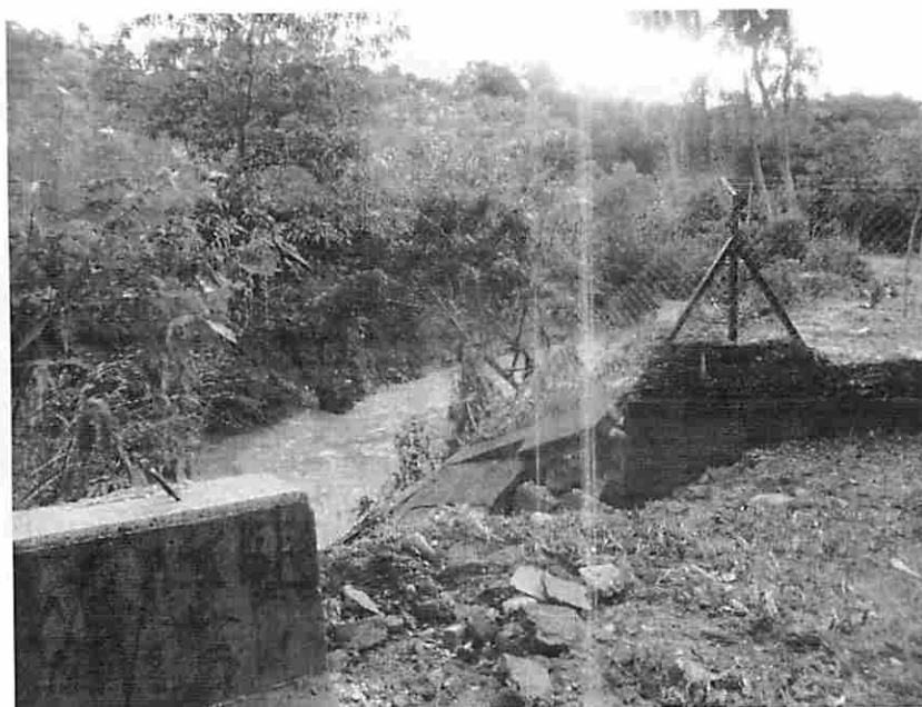
Foto 42. Parte danificada da ponte.
