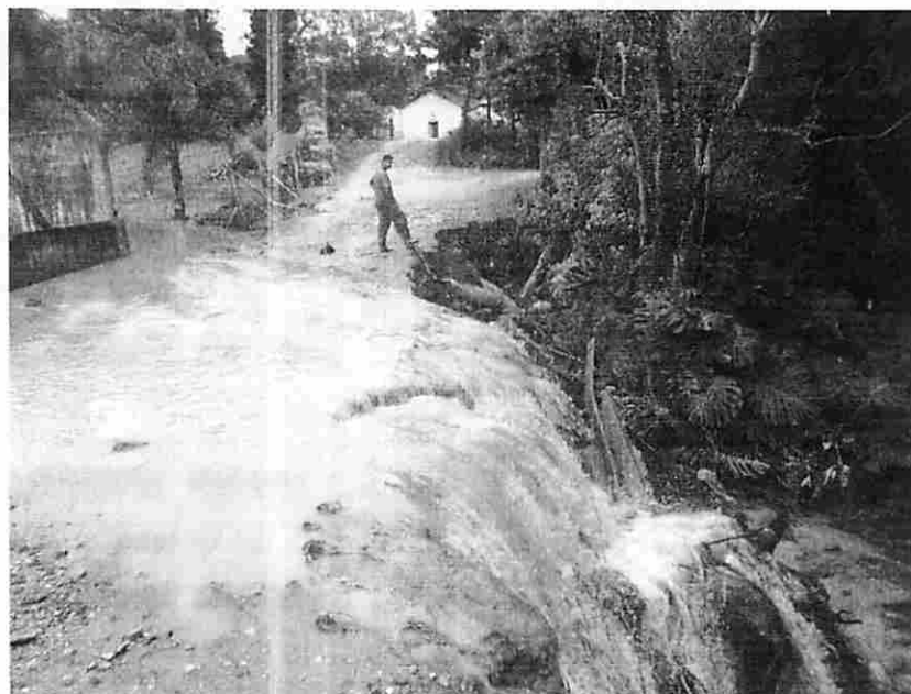
Foto 19. Vista mais próxima do ocorrido, nota-se erosão e um desgaste do talude provavelmente a sumidouro esta entupida.
