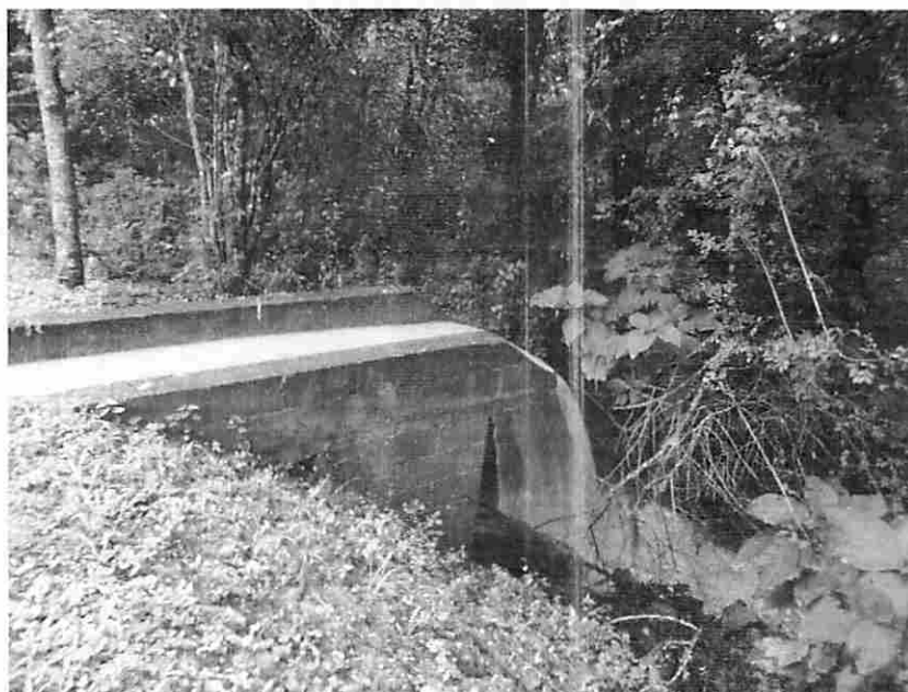
Foto 21. Sangradouro do lago onde não suportou a quantidade de água.
