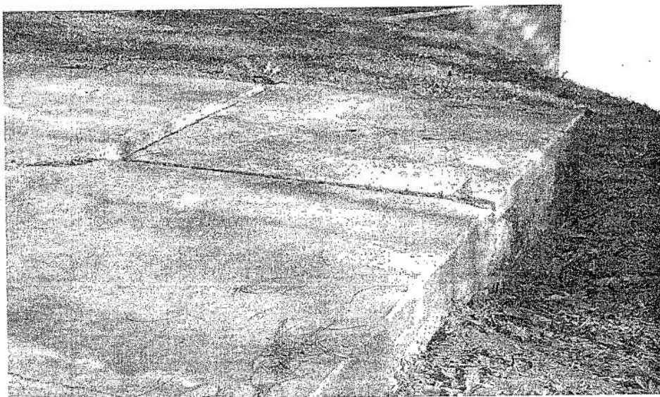
Foto 4: Talude com recalque na calçada
