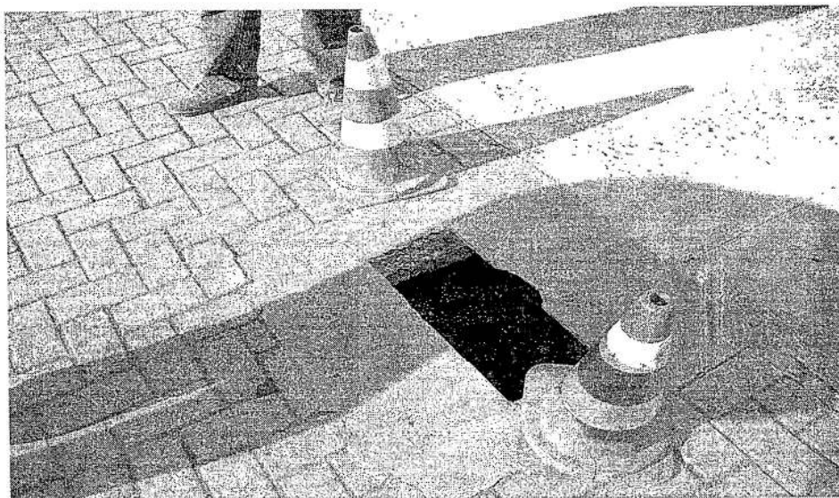
Foto 09: Caixa de águas pluviais sem grelha
