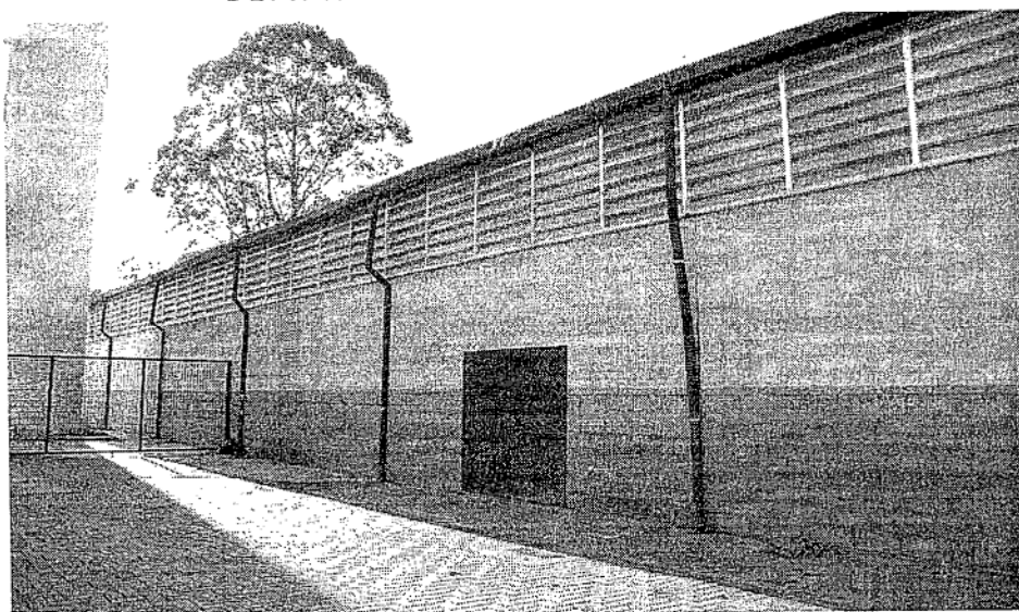
Foto 12: Condutores da quadra soltos e umidade na parede
