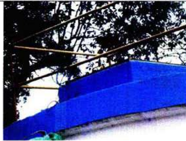
Foto 37: Reservatório Mailasque – Tampa sem cadeado.
