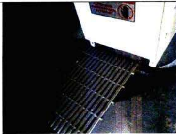
Foto 16: Captação Sorocamirim - Painel Elétrico - Grade inadequada
