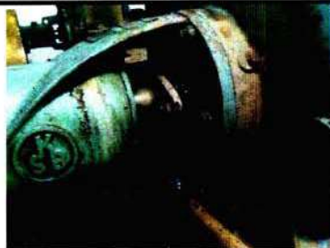
Foto 4: Captação Junqueira – Vedação por gaixetas – vazamento excessivo.
