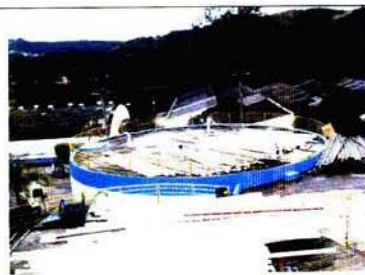
Foto 78: Reservatórios de Água Tratada – Armazenamento inapropriado de materiais e respiradouros sem tela de proteção
