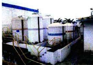
Foto 77: ETA São Roque – Reservatório de Produtos Químicos – Necessita de Identificação
