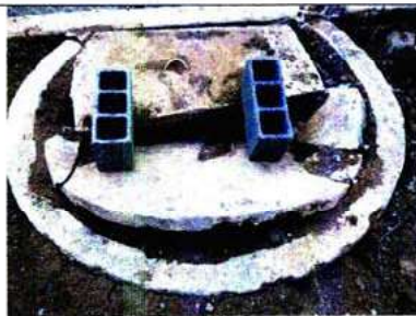
Foto 39: Reservatório Mailasque – Tampa danificada
