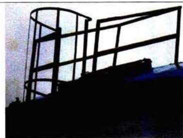
Foto 68: Reservatório Gabriel Pizza – Sem cadeado na tampa – Sem tela de proteção na tampa do respiradouro
