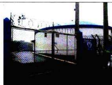
Foto 70: Reservatório Mosteiro– não há tela de proteção no respiradouro do reservatório
