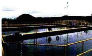
Foto 75: ETA São Roque - Decantadores
