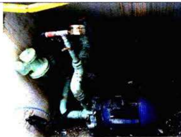
Foto 50: Booster Finatti 01- Vazamento
