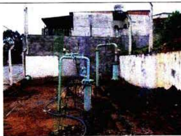
Foto 65: Booster Jd. Brasília e Booster Marieta – Necessita de Manutenção Geral
