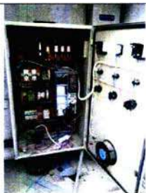
Foto 49: Booster Finatti 01 – Painel elétrico Necessita de limpeza e Manutenção Preventiva.
