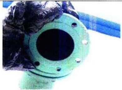
Foto 38: Reservatório Mailasque – Extravasores sem tela de proteção
