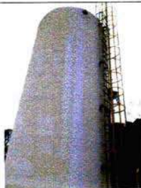
Foto 52: Reservatório Alpes do Guaçu
