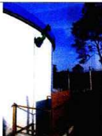
Foto 26: Reservatório São João – Extravasor sem tela protetora
