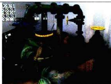
Foto 2: Captação Junqueira - EEAB
