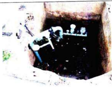
Foto 32: Booster Vila Vinha - Vazamento
