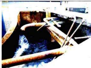
Foto 74: ETA São Roque - Entrada da água
