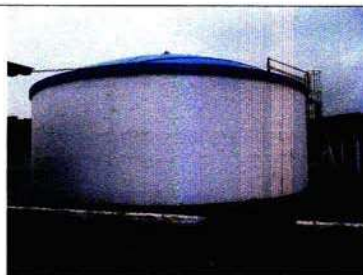
Foto 62: Reservatório Marieta – Não há ela de proteção no respiradouro do reservatório.
