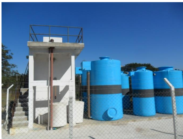
Foto 3 – Apontamos a necessidade de conclusão das obras.
