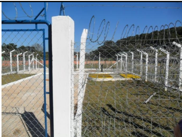
Foto 5 – Vista geral da EEE-Carmo.
