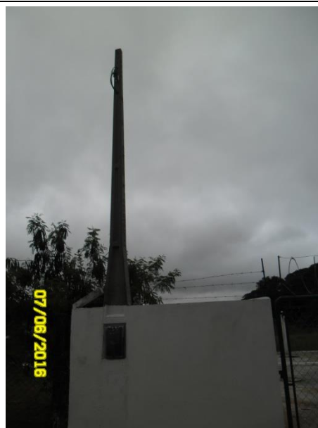
Foto 19 – Unidade ainda sem energização.
