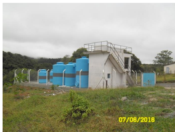
Foto 23 – Unidade ainda sem energização.
