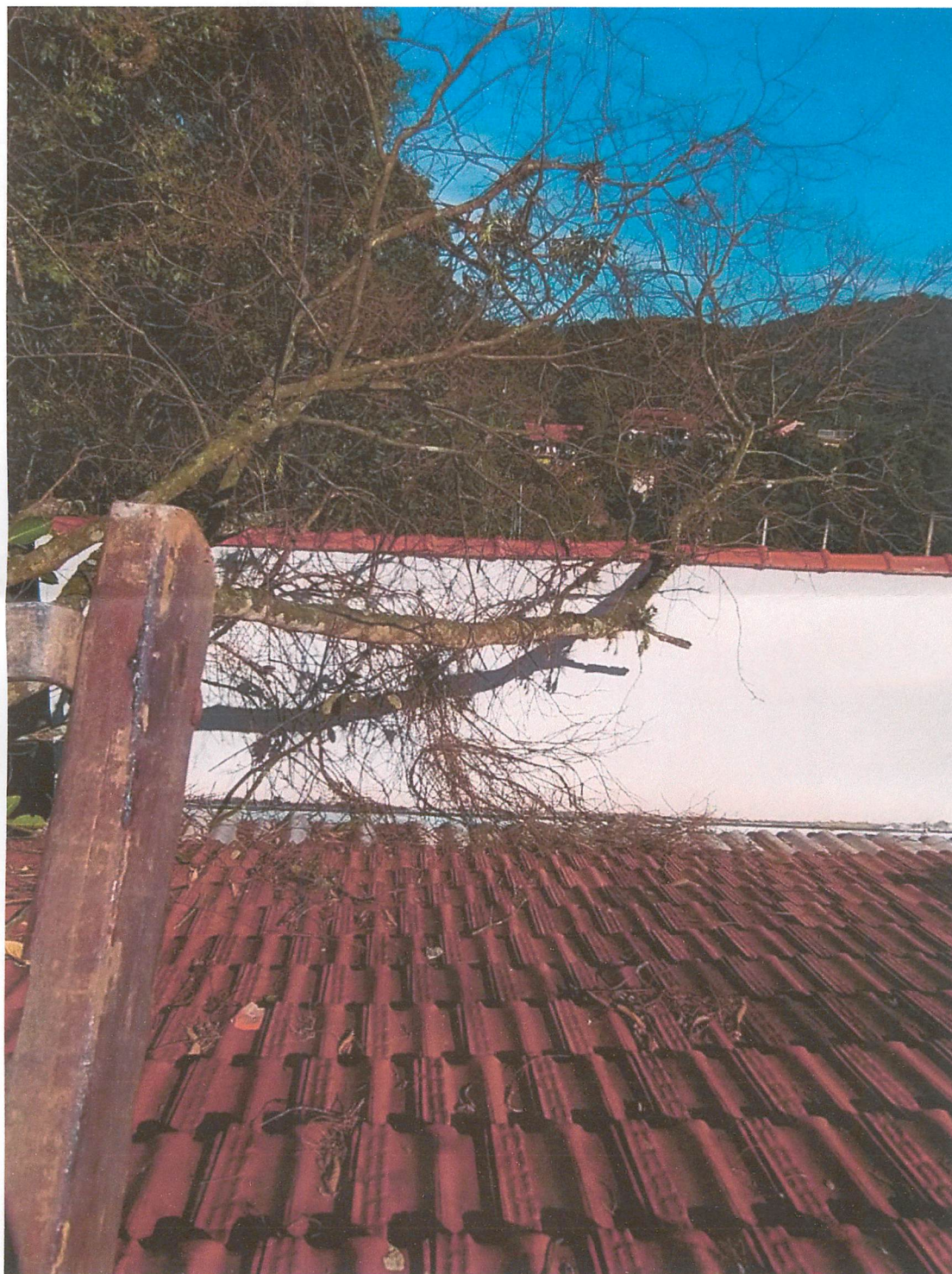
12.04.2020 – Data das quedas das árvores – Conjunto Habitacional Lago dos Patos
