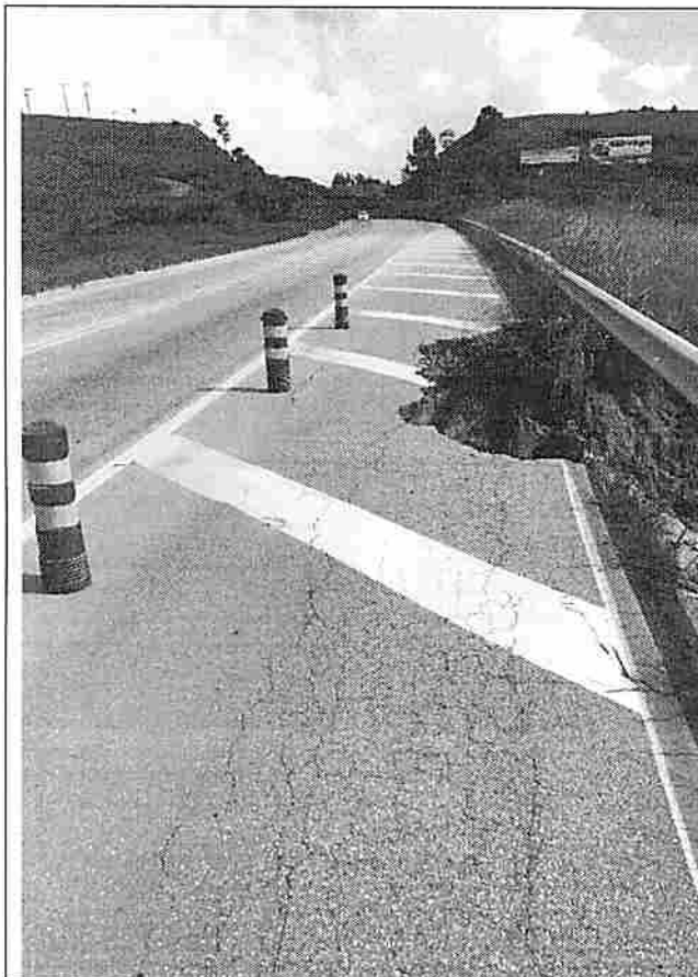
Foto n.º 07 – Km 4,5 – Vista do talude rompido
