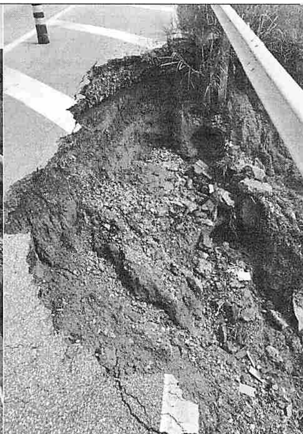
Foto n.º 08 – Km 4,5 – detalhe da erosão do talude
