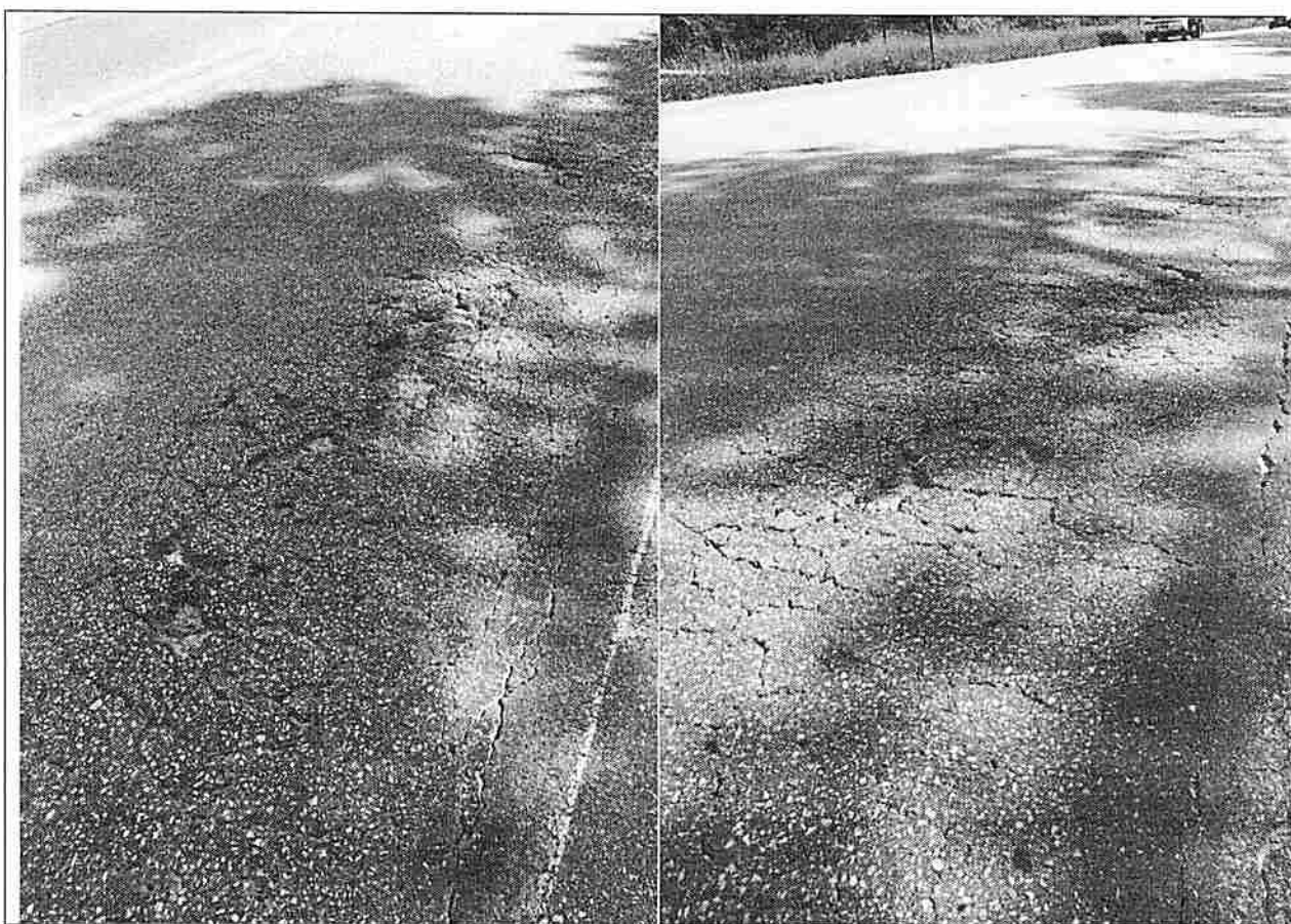
Foto n.º 01 - Km 02 - Trincas, fissuras e buracos na pista de rolamento da Rodovia
