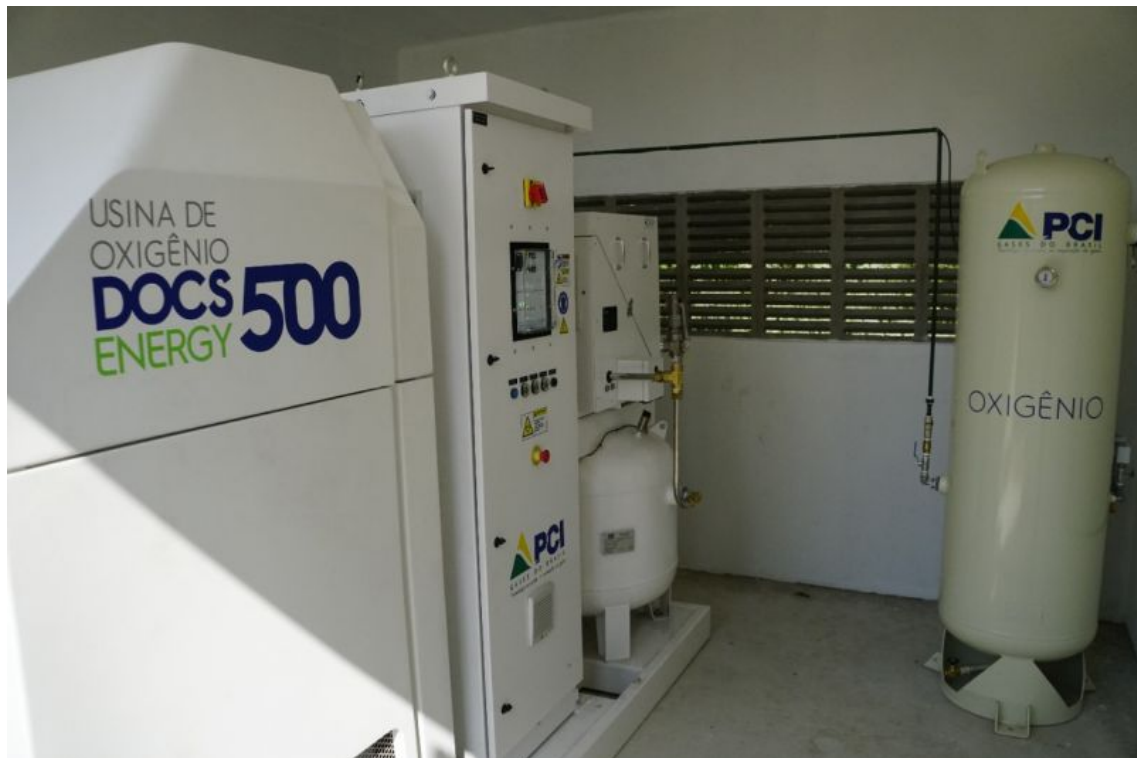
Usina de oxigênio instalada na Santa Casa de Misericórdia de São Roque, obtida por meio de emenda do Deputado Estadual Ataíde Teruel
