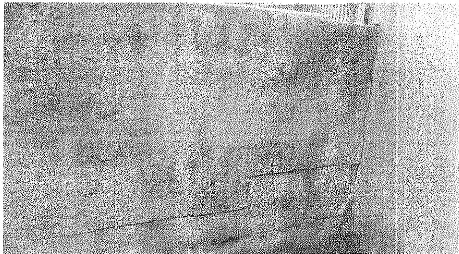
MURO APRESENTANDO RISCO DE CAIR
